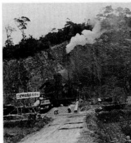
長崎佐世保線・大串・亀岳 アスファルトプラント
